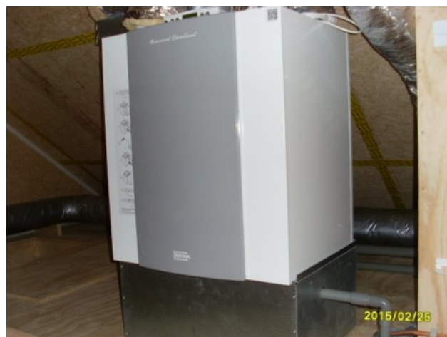
Op de foto het balansventilatiesysteem
